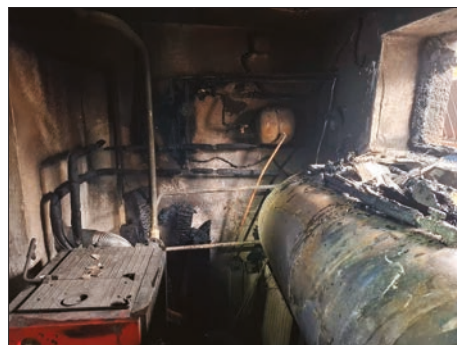
Výjezd č. 6 – Požár kotelny rodinného domu
